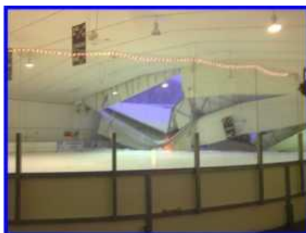
Рис. 4. Обрушение кровли ледового катка «Полюс», г.Владивосток г.Чусовой, Пермский край (04.12.2005 г.)
