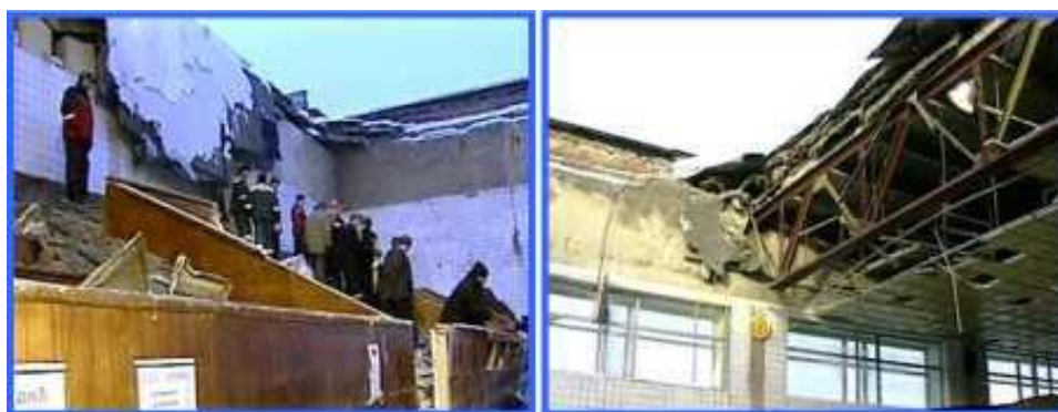
Рис. 5. Обрушение кровли кирпичного трёхэтажного бассейна «Дельфин», г. Чусовой, Пермский край
