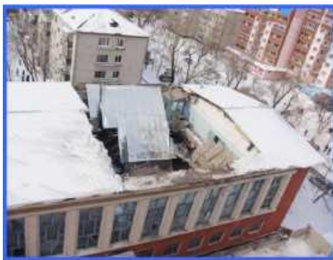
Рис. 3. Обрушение крыши спортивного комплекса «Спартак», г. Благовещенск г. Владивосток (05.12.2009 г.)
