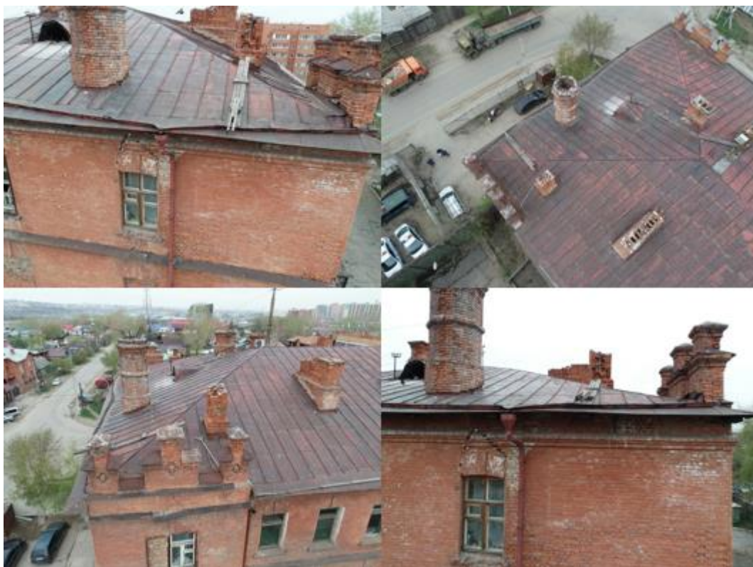
Фотоснимки фасада и кровли с зафиксированными дефектами
