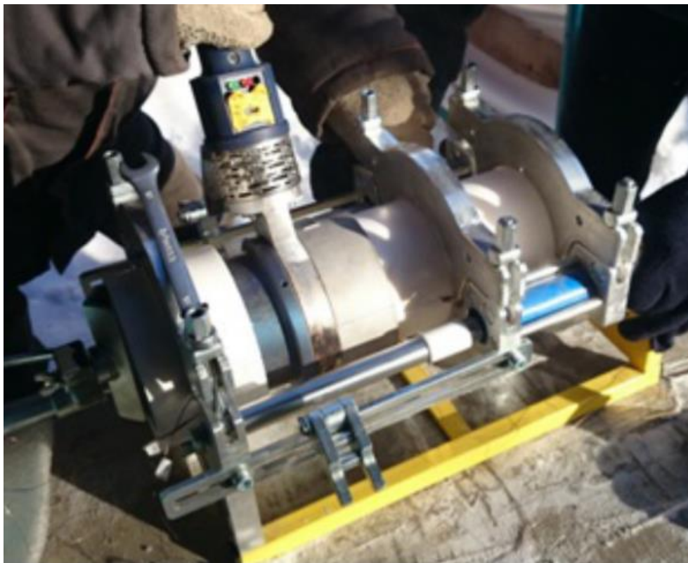
Рис. 4. Оплавление внешней поверхности трубы и внутренней поверхности муфты
