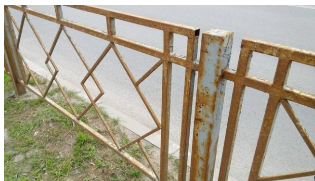
Рис. 6. Металлический забор, покрытый коррозией
